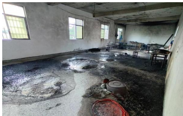
图 1.7 非法作业点内部过火烟熏情况
