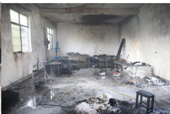
图 1.13 墙体无 V 字型烟熏燃烧痕迹
