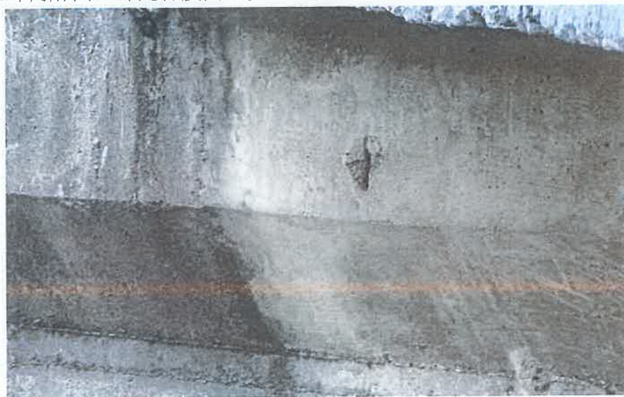
照片 5-2 2#墩帽右侧 1.2m 处破损露筋
