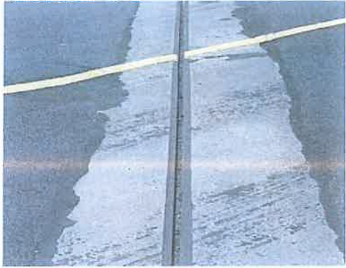
照片 5-10 2#伸缩缝部分堵塞
