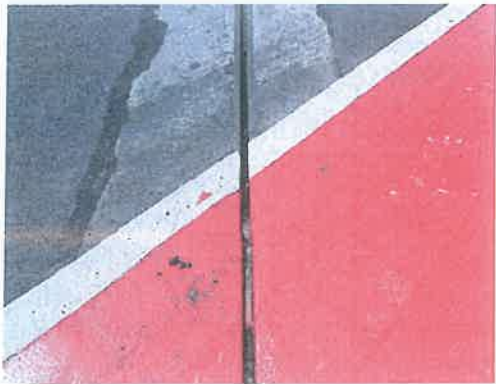
照片 5-9 1#伸缩缝部分堵塞
